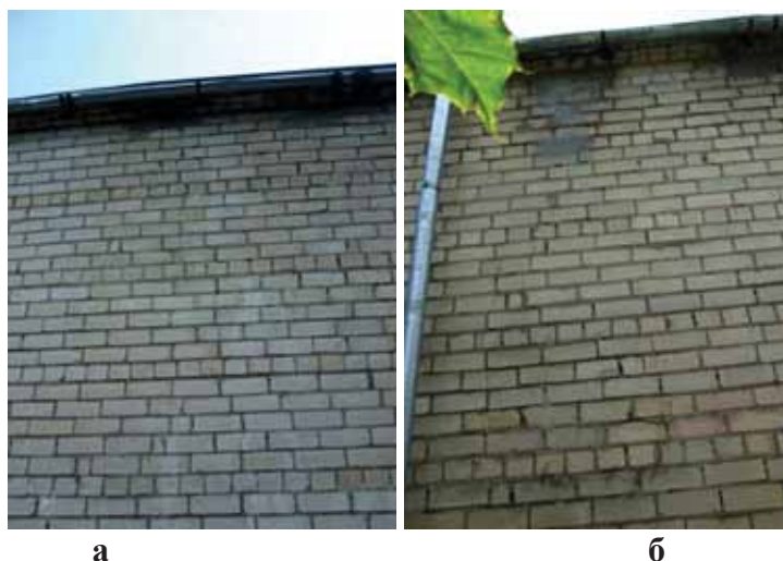
Рис. 6 – Сквозные трещины в кирпичных стенах пристройки фасадов: а) А – Н; б) Н – А
